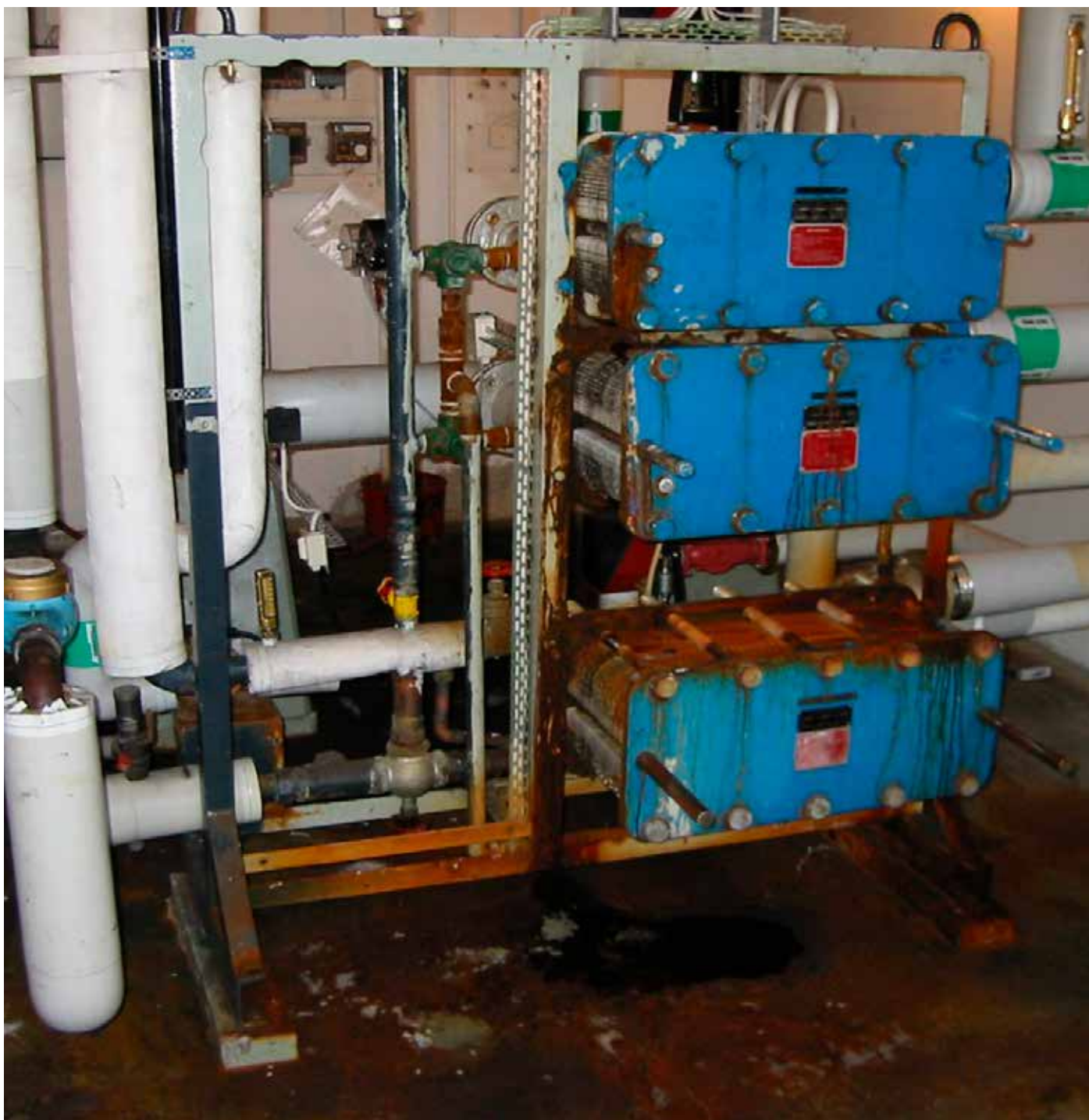
2003: UC före ombyggnad. De blå "paketen" är plattvärmeväxlare för överföring av värmeenergi från fjärrvärmenätet till värmeelement, varmvatten och ventilationens tilluft.
